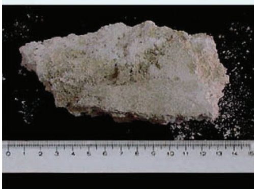
Fragmento de concreto após spalling
